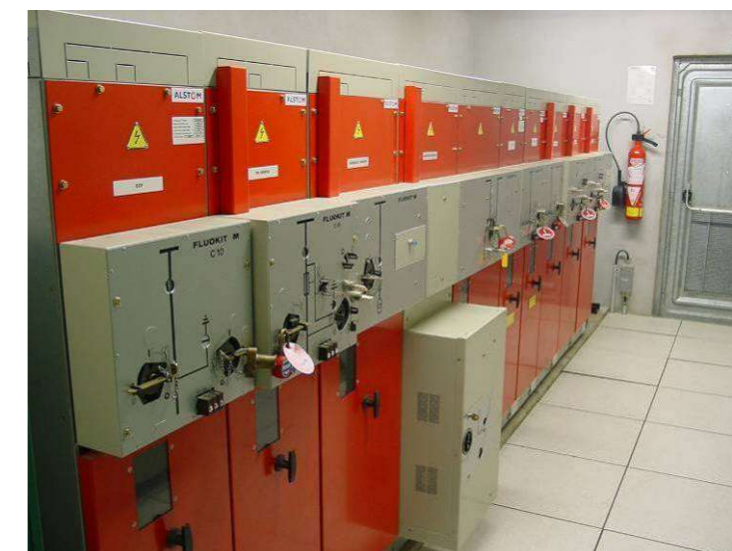
Illustration 11 : Intérieur d'un poste de livraison
